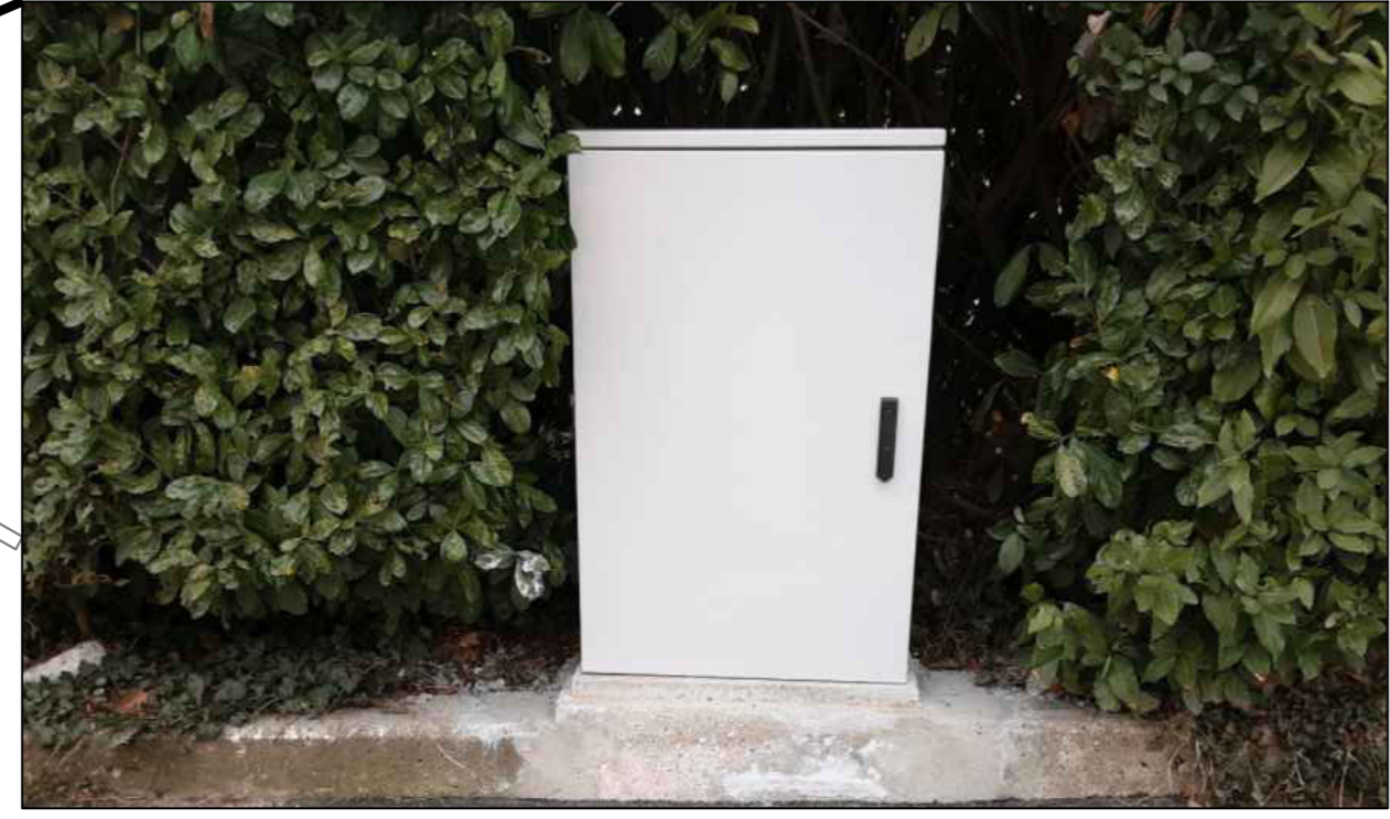
STATO REALIZZATO SPOSTATO RISPETTO AUTORIZZAZIONE 9163 del 02/02/2020 - ARMADIO TECNICO 'G221_CNO1' - VIA ALDO FANTINA
