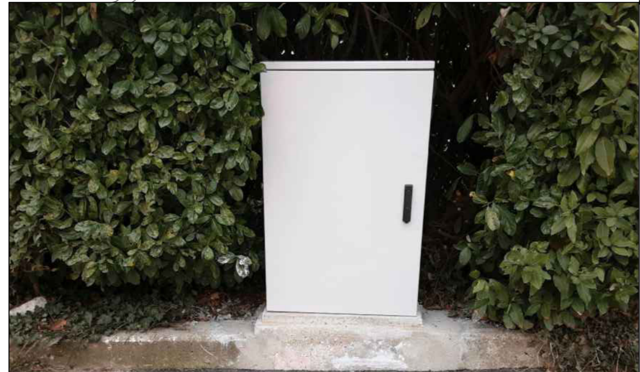
STATO REALIZZATO SPOSTATO RISPETTO AUTORIZZAZIONE 9163 del 02/02/2020 - ARMADIO TECNICO "G221_CNO2" - VIA MONTE GRAPPA
