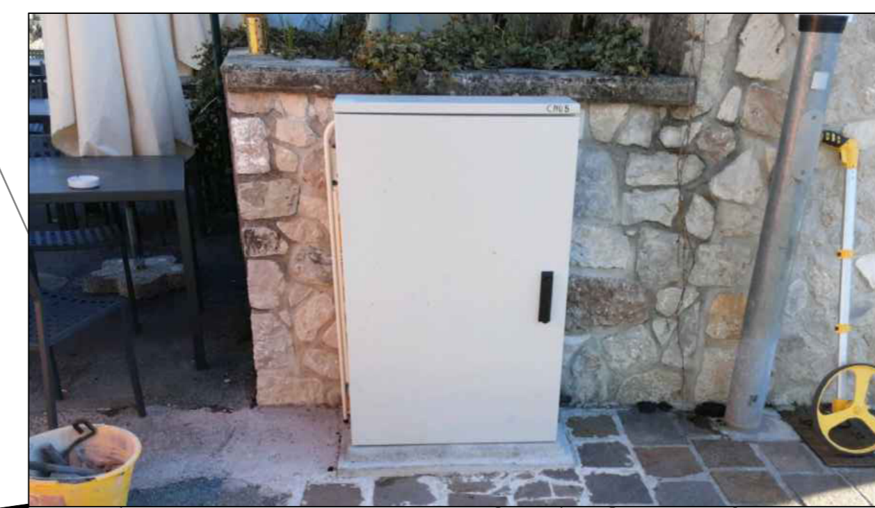
STATO REALIZZATO E AUTORIZZATO CON AUTORIZZAZIONE 9163 del 02/02/2020 - ARMADIO TECNICO 'GZZ1_CN05' - VIA BOSCHI
