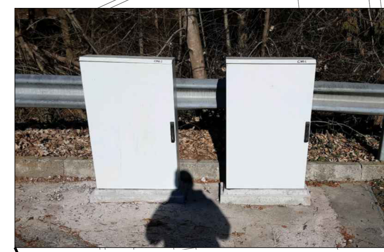
STATO REALIZZATO E AUTORIZZATO CON AUTORIZZAZIONE 9163 del 02/02/2020 - ARMADIO TECNICO "G221_CNO3" - VIA GENERALE GIARDINO
