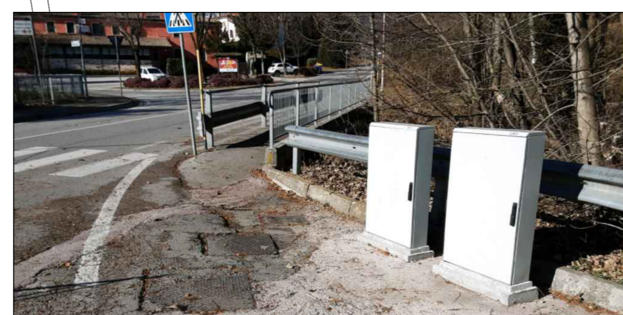
STATO REALIZZATO E AUTORIZZATO CON AUTORIZZAZIONE 9163 del 02/02/2020 - ARMADIO TECNICO "G221_CNO3" - VIA GENERALE GIARDINO
