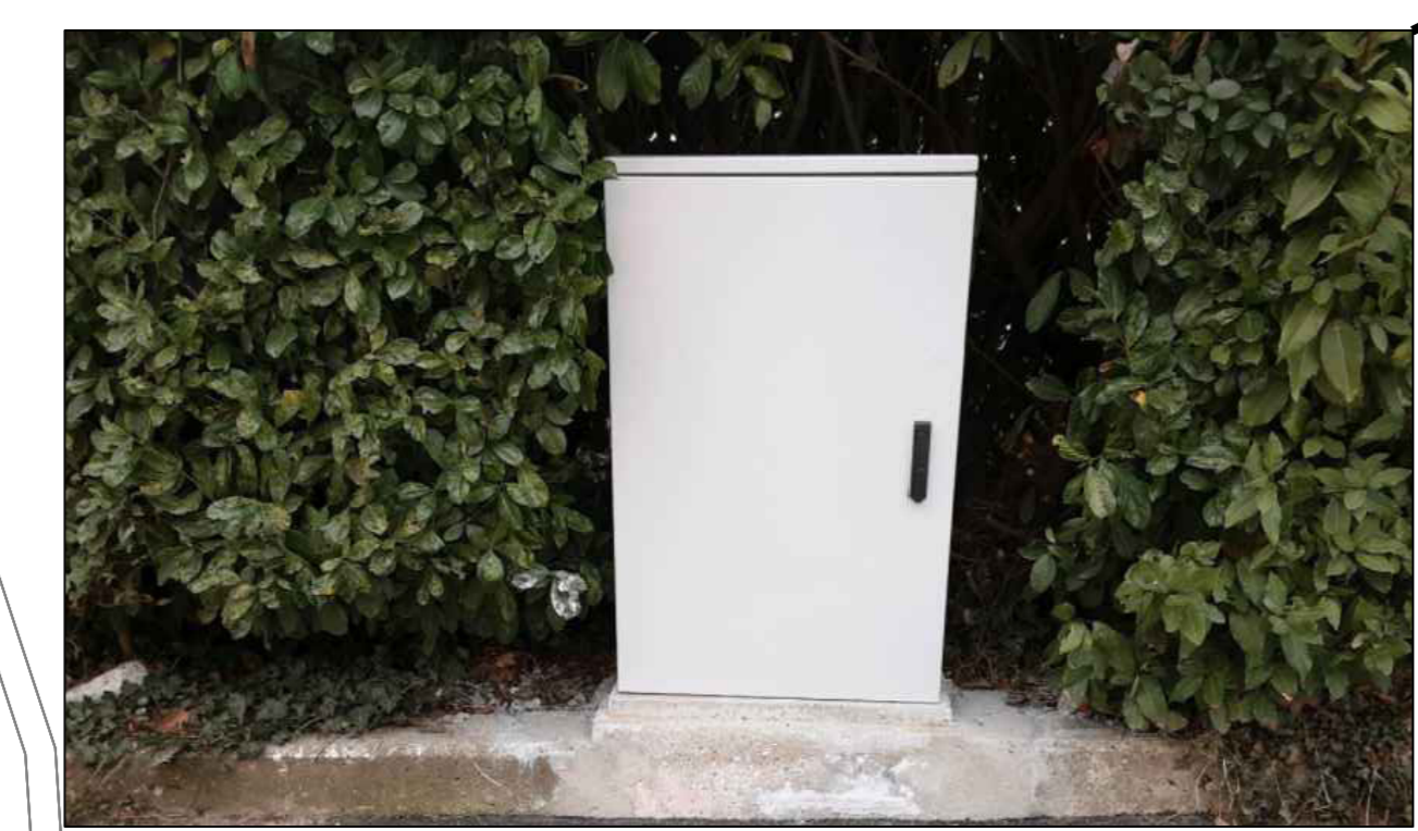
STATO REALIZZATO E AUTORIZZATO CON AUTORIZZAZIONE 9163 del 02/02/2020 - ARMADIO TECNICO 'GZZ1_CN04' - PIAZZA FIETTA
